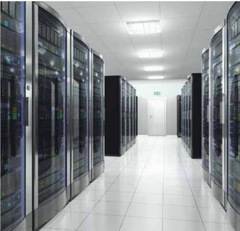
Rechenzentren stellen die Grundlage für alle Arten von Cloud-Anwendungen dar.
