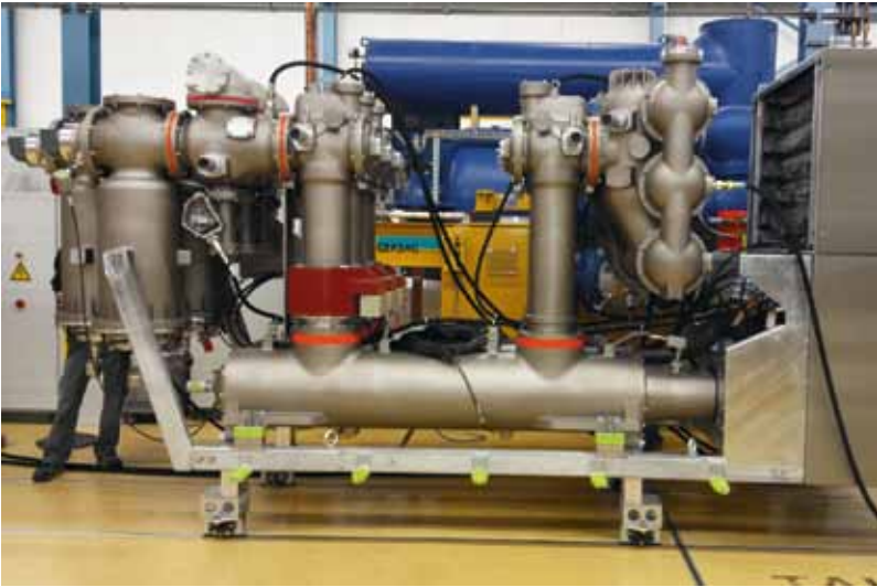
Die erste gasisolierte Schaltanlage (GIS) mit ökoeffizientem Isoliergasgemisch.
